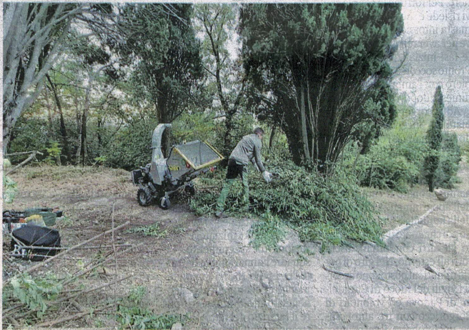
Gli operai impegnati nella pulizia della scalinata e nel taglio della vegetazione infestante
